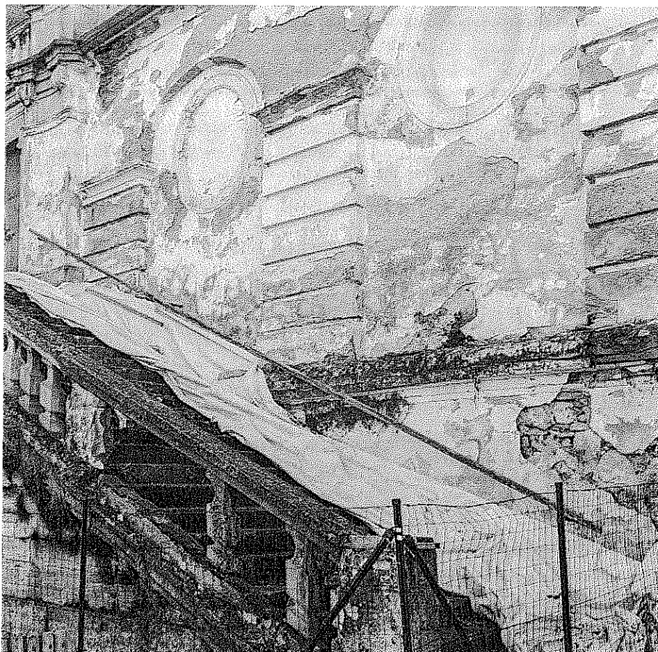
Slika 15: Fotografija stanja severne fasade in stopnišča
